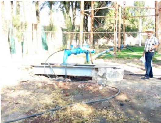
Imagen I.33. Pozo Unidad deportiva. Fuente: H. Ayuntamiento 2012-2015.
