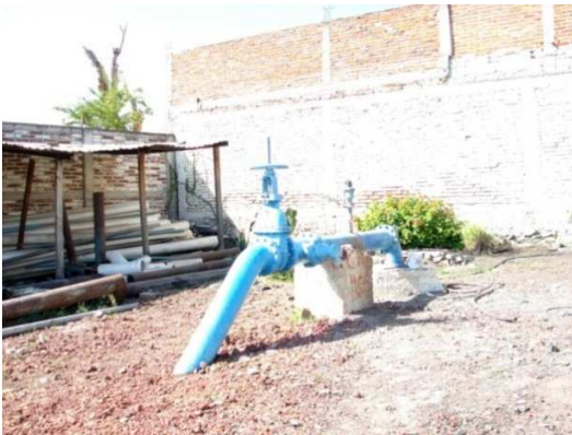
Imagen I.40. Pozo Aramburo. Fuente: H. Ayuntamiento 2012-2015.
